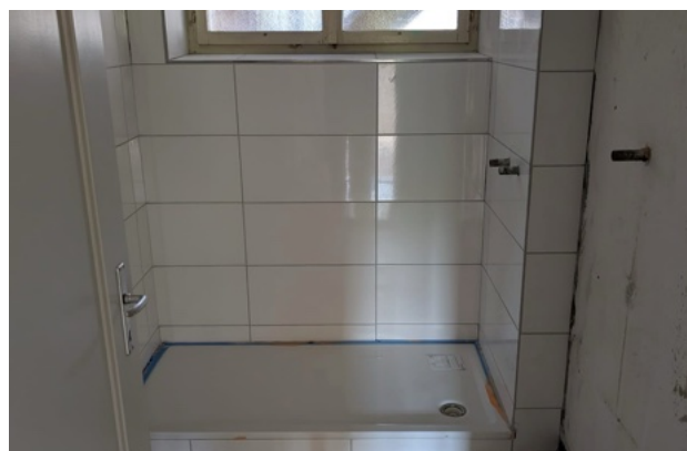
EG · Bad, erneuert 2025
