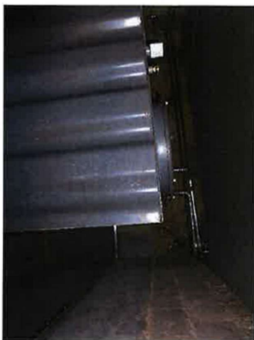
Citerne à mazout
